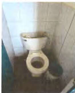
Foto 3: SERVICIOS SANITARIOS Y SUS ACCESORIOS
