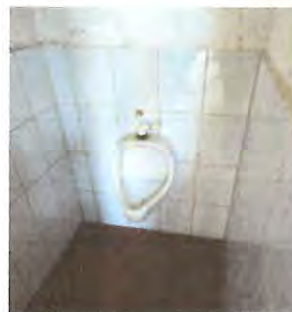
Foto 4: SERVICIOS SANITARIOS Y SUS ACCESORIOS
